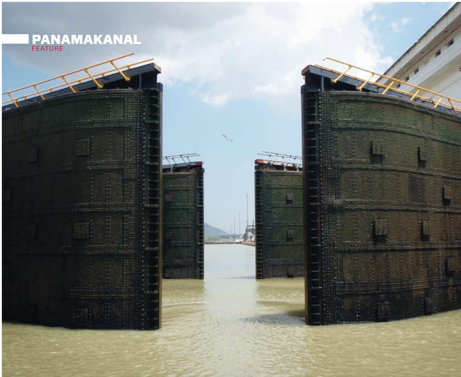
TORÖFFNER. Die zwei Meter dicken Schleusentore wiegen 700 Tonnen und werden von einem 400 PS starken Elektromotor angetrieben
